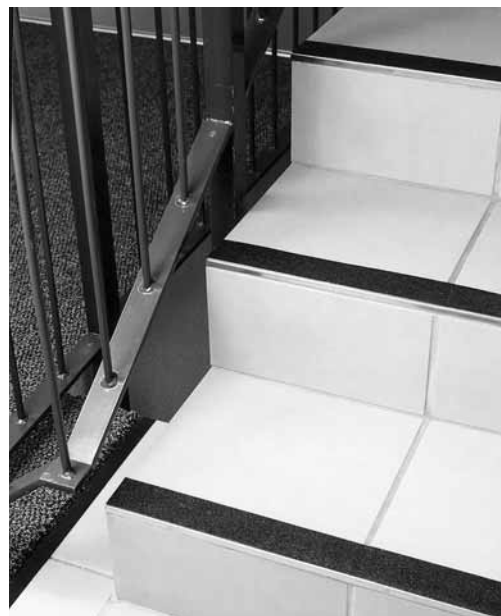
Fig. 2: bandes antidérapantes installées ultérieurement sur un escalier en pierre lisse.
